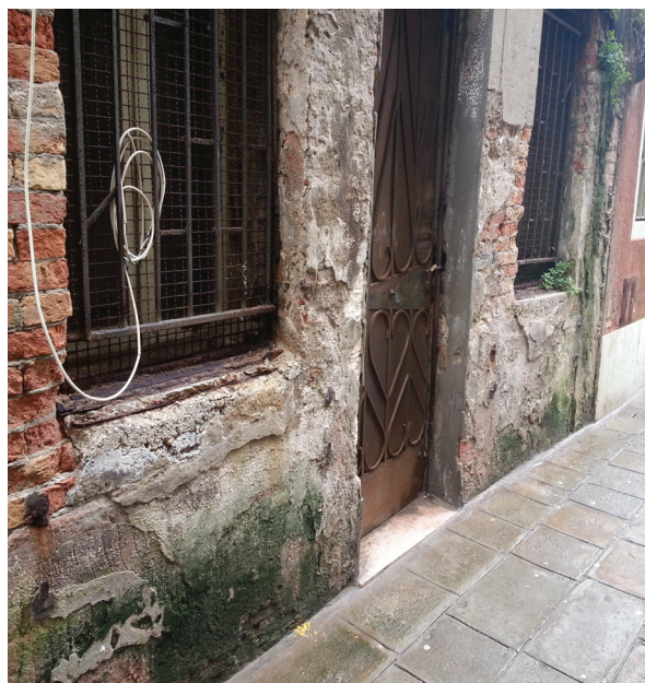
Poškodbe zaradi kapilarne vlage
