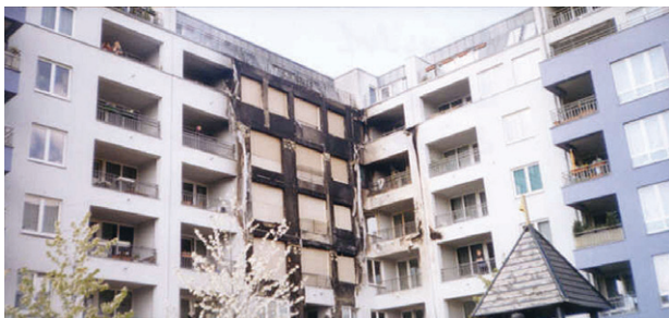
Sliki E.1: Širjenje požara preko fasadnih oblog in vidna škoda po požaru v večstanovanjski stavbi, 21. april 2005. (Vir: Letno poročilo berlinskih gasilcev za leto 2005, http://www.richtigbauen.de )
